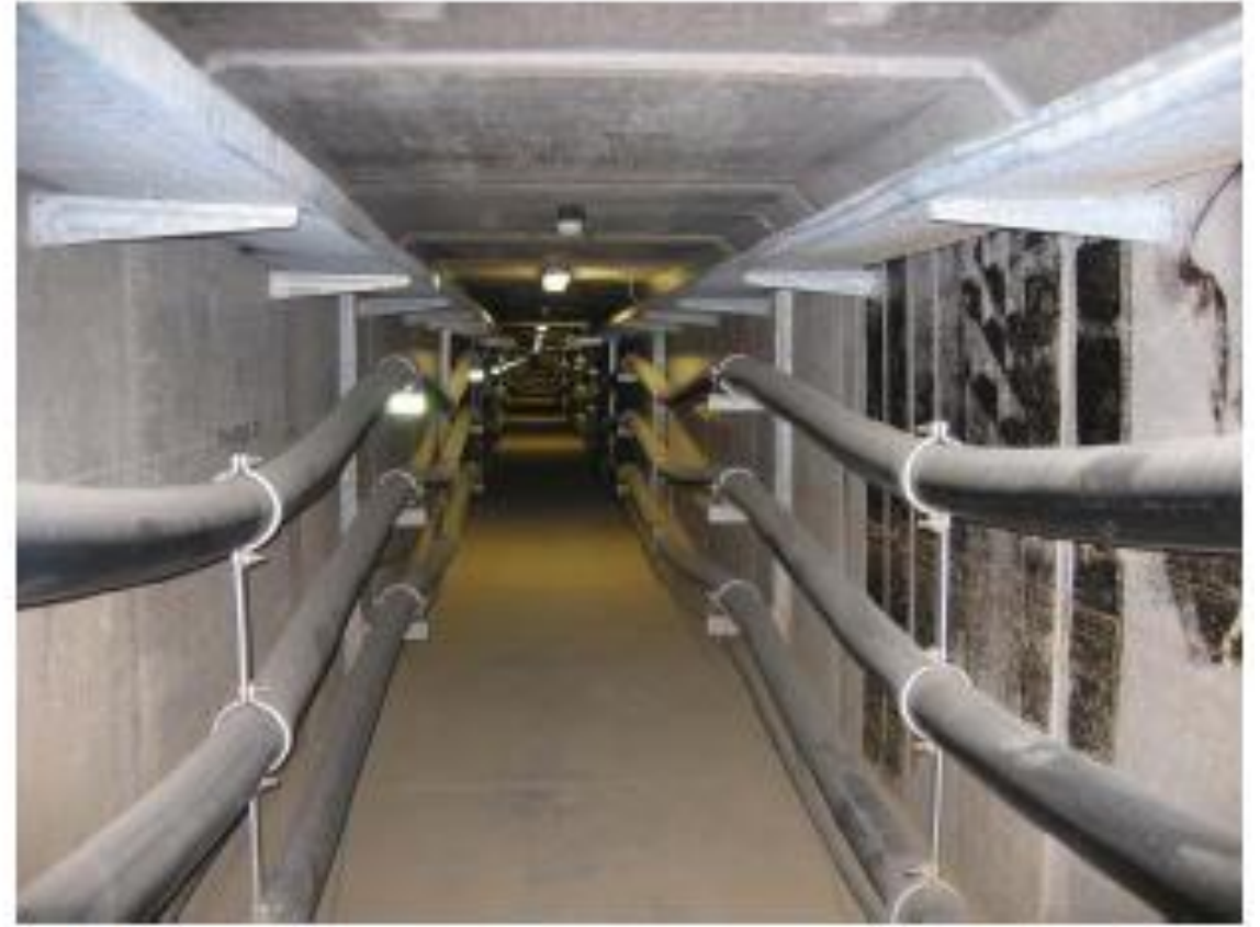
Bild 6.6. Kabeltunnel Flughafen Madrid
