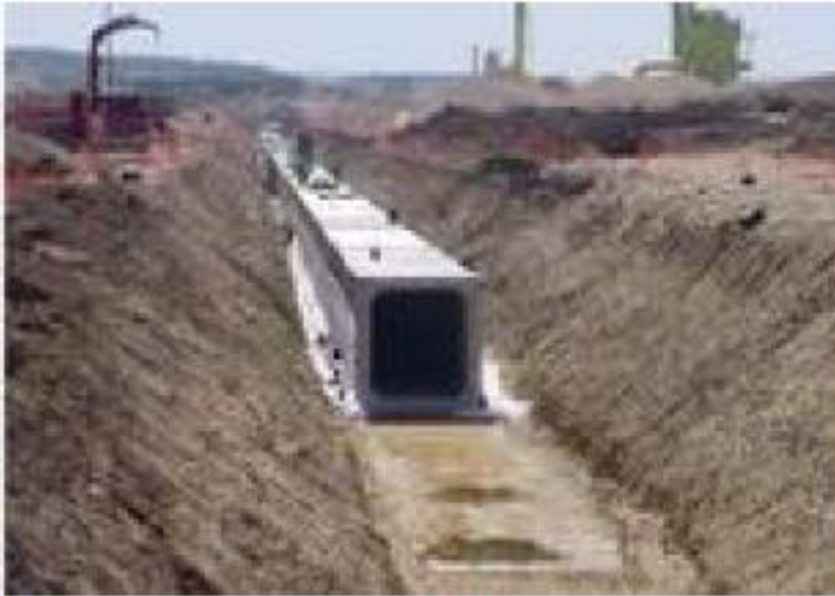
Bild 6.5. Kabeltunnel Flughafen Madrid
